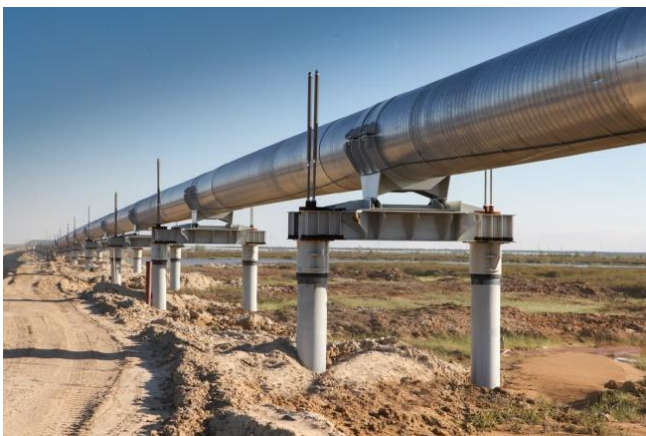
Рис.34. Трубопровод на опорах
